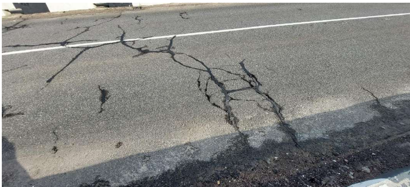
Pav. 3 Kelio danga sutrūkinējusi
