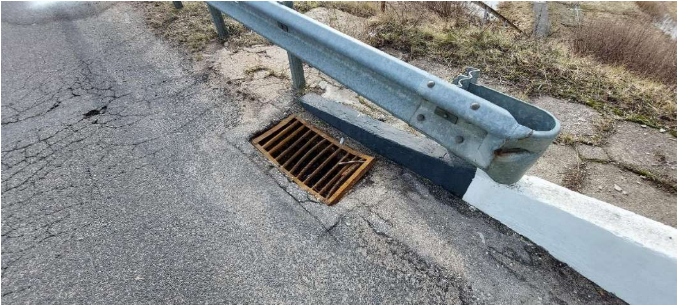
Pav. 6 Vandens surinkimo šulinėlių grotelės sulankstytos, korodavusios, susmegusios į asfalto dangą
