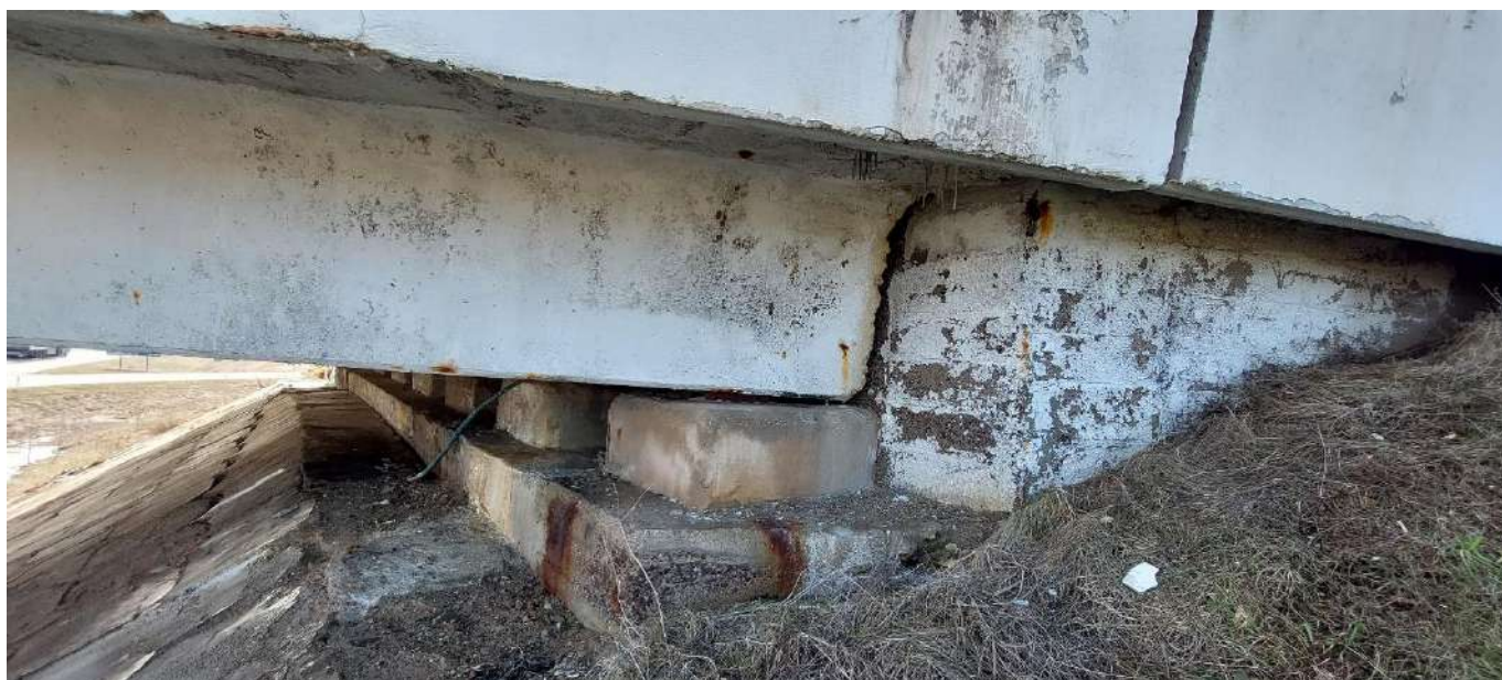
Pav. 11 Kraštinė atrama. Aptrupėjęs apdailinis sluoksnis, pažeistas apsauginis betono sluoksnis
