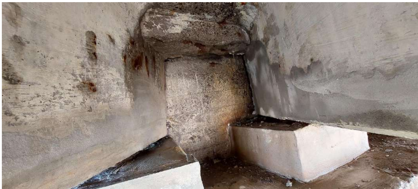
Pav. 10 Kiauras deformacinis pjūvis, vanduo patenka ant sijų galų ir atraminių guolių, pažeistas perdangos sijų apsauginis betono sluoksnis, koroduoja perdangos armatūra
