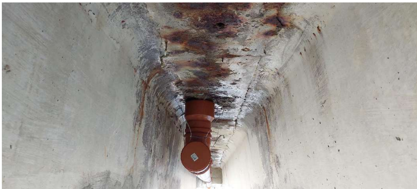
Pav. 9 Pažeistas perdangos sijų apsauginis betono sluoksnis, koroduoja perdangos armatūra
