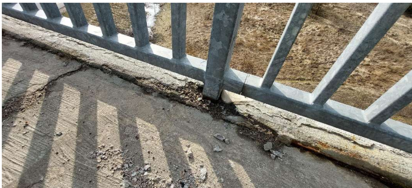
Pav. 5 Ištrupėję turėkliniai blokai, koroduoja turėklų statramsčiai
