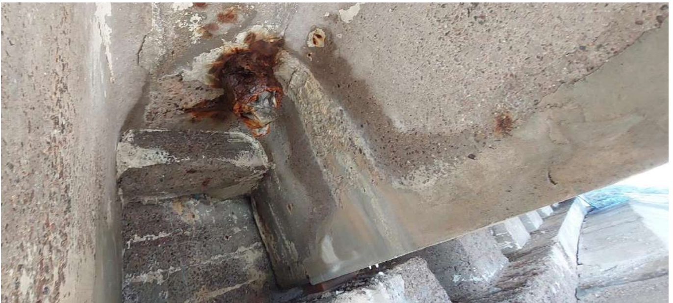
Pav. 7 Kiaura hidroizoliacija aplink vandens nuleidimo šulinėlį, šulinėlis neprijungtas prie vandens nuvedimo sistemos, vanduo bėga ant kraštinės atramos.
